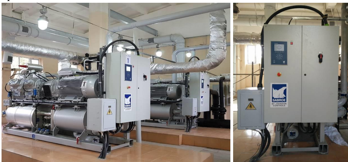
Рисунок 2. Общий вид нового чиллера, работающего на R717
