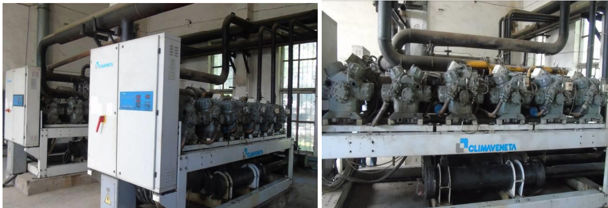
Рисунок 1. Общий вид устаревшего чиллера, работающего на R22.
